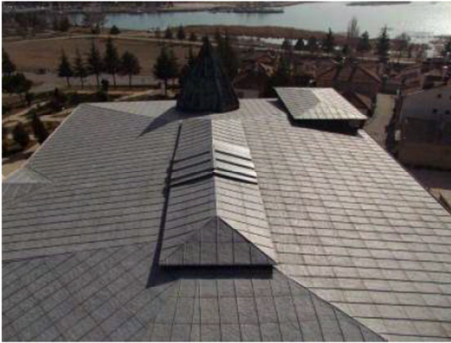
Fotoğraf 20. Yapının Üst Örtüsü (Kaynak: Konya Vakıflar Bölge Müdürlüğü, Beyşehir Eşrefoğlu Camii ve Külliyesi Sanat Tarihi Raporu)
